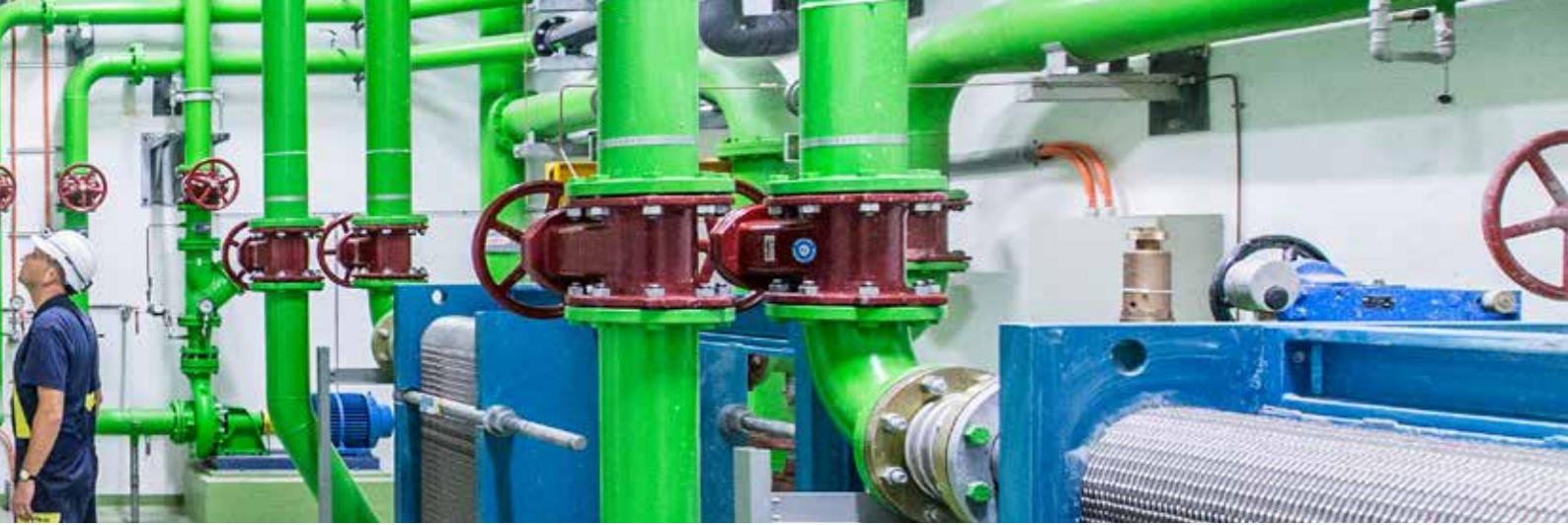
Altes Kühlwassersystem im Kraftwerk Martina, das im 2018 ersetzt wurde.
